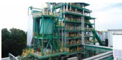
バイオマスボイラの流動砂として
